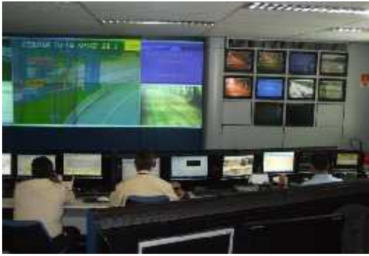
Figura 3 - Central de monitoramento
